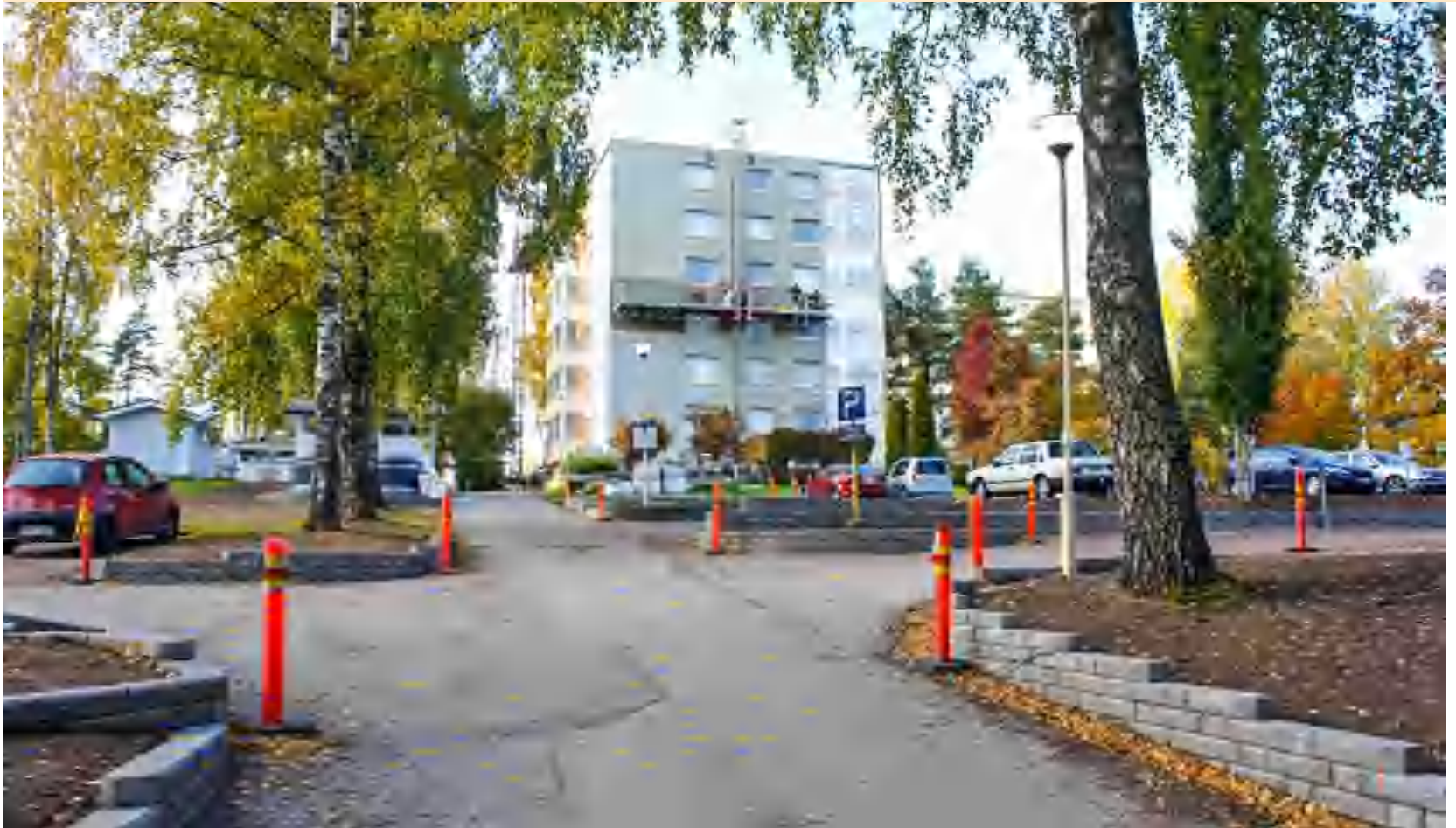
Yhtä aikaa julkisivukorjausten kanssa Peipontie 2:ssa on tehty näkyviä piha-alueiden kunnostuksia. Uudet asfaltit laitetaan keväällä.
